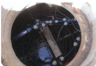
©Fernwärme Weiz GmbH
